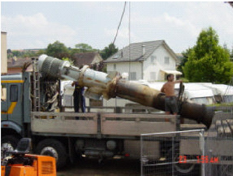
Démontage de la pompe 2 le 29.07.03, après avoir reçu un dispositif de remplacement ; opération simultanée de sortie et installation des pompes provisoires.
