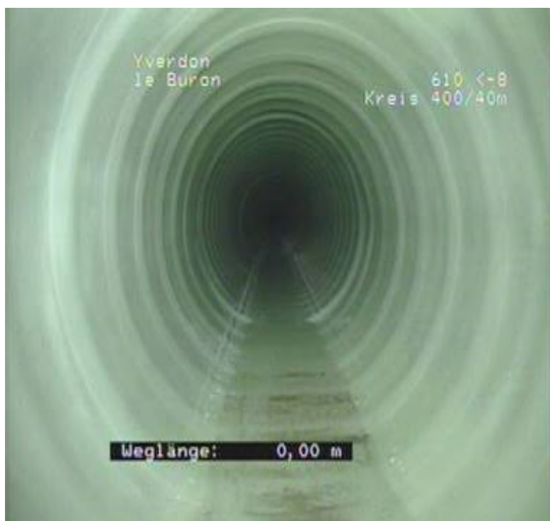
Figure 3 - Etat du collecteur de concentration du Buron réhabilité (2020)
