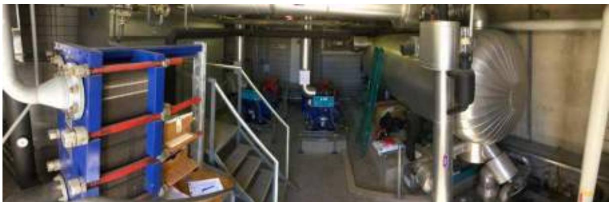
Figure 3-5 : Vue générale du local technique
